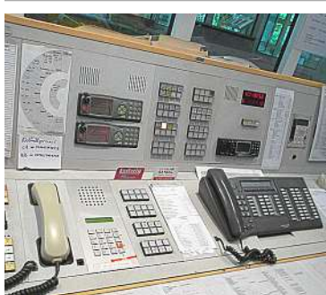
Die Schaltzentrale. Foto: Eric
