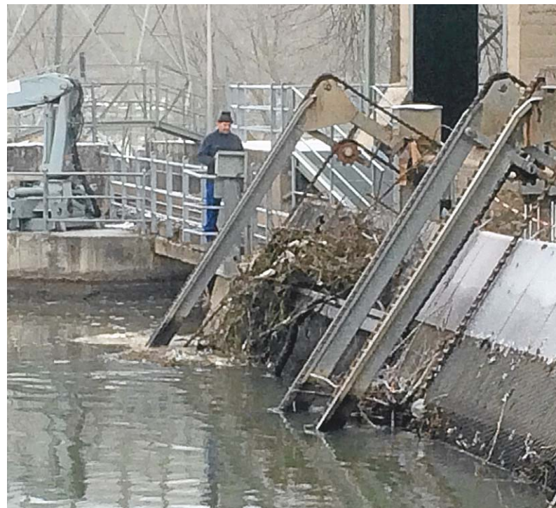
Der Kraftwerkskanal mit seinem Rechen.
