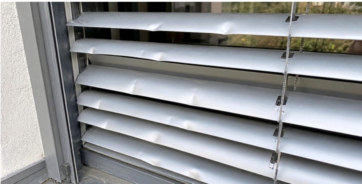
Hagel kann Beschattungssysteme innerhalb weniger Minuten erheblich beschädigen.
