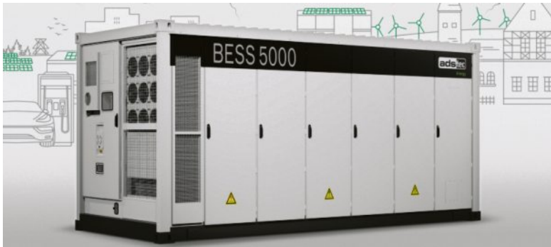
Der neue Batteriespeicher der SWLB.
